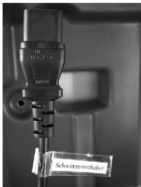
Bild 8 Elektrischer Anschluss der Box
